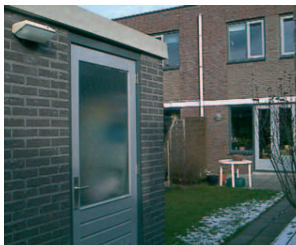
Energiezuinige verlichting op schemerschakelaar
