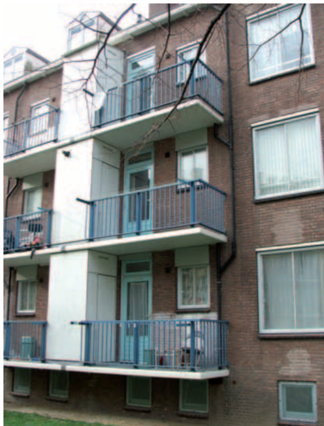
Door eenvoudige opklimmogelijkheden (regenpijp) is het tweede balkon bereikbaar en gelegen binnen 5,5 m vanaf het maaiveld. Daar dient dus ook verlichting te komen.
