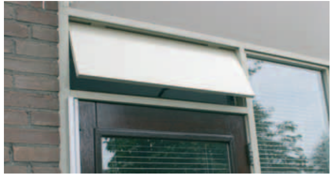
Let ook op ventilatieopeningen
