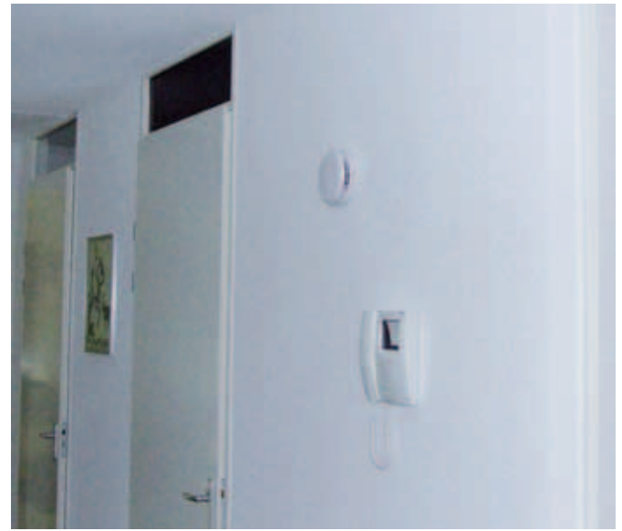
Deze rookmelder is te laag op de muur geplaatst
